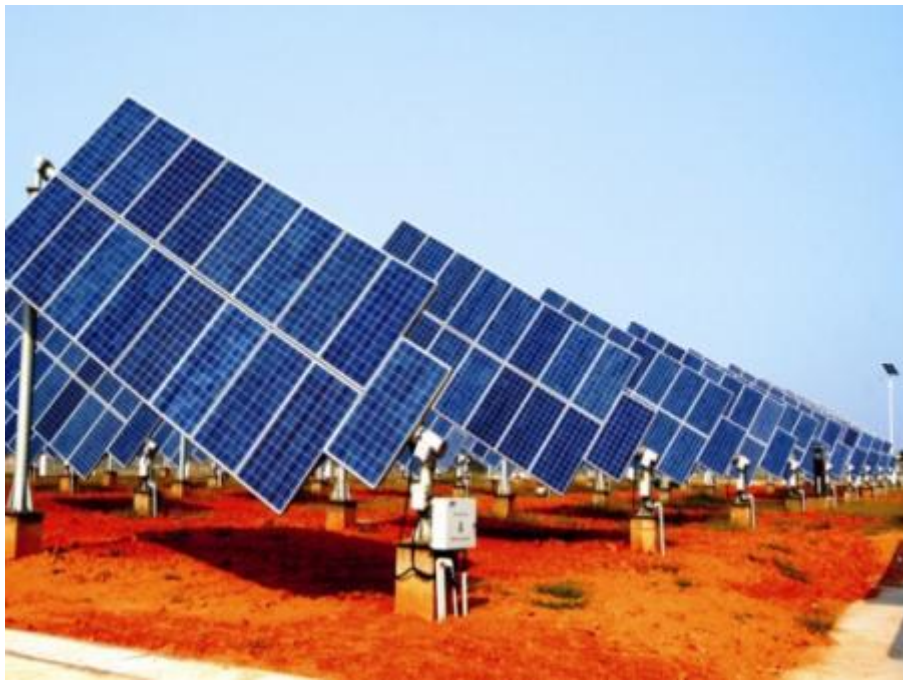
图：南昌奥克 6MW 地面光伏电站
