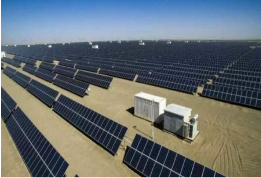
图：格尔木 20MW 地面光伏电站
